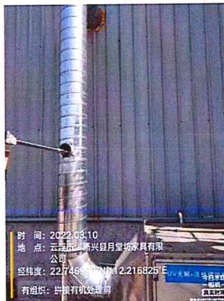
图 4: 一期拼接有机废气处理前监测点
