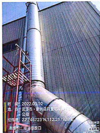
图 3: 一期调漆、喷漆、晾干有机废气排放口监测点
